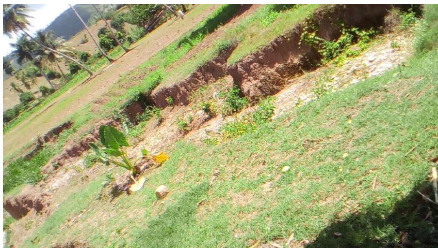
Photo 3 : Crevasses laissées par les inondations des berges Photo Hugues Foucault
