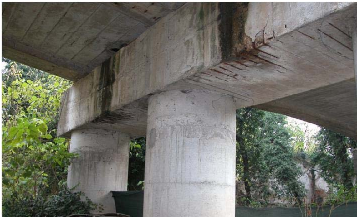
Figura 8. Mancanza dei tubi di drenaggio delle acque di piattaforma (?) che causa lo sversamento delle acque sul pulvino causando la corrosione delle armature e il successivo distacco di parti del copriferro presso il viadotto di accesso al ponte di Ficarolo.
