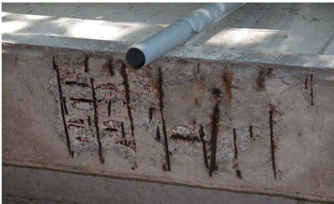
Figura 6. Corrosione dei cavi di precompressione lungo il viadotto di accesso al ponte di San Daniele.
