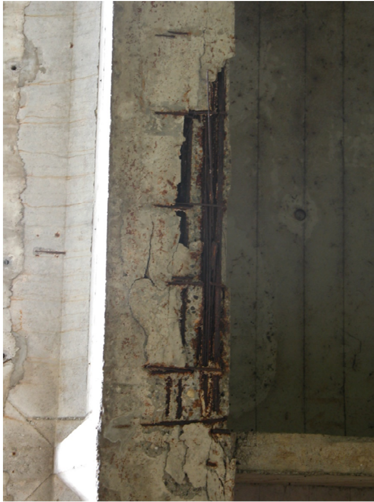
Figura 5. Corrosione dei cavi di precompressione lungo il viadotto di accesso al ponte di Pieve Porto Morone.
