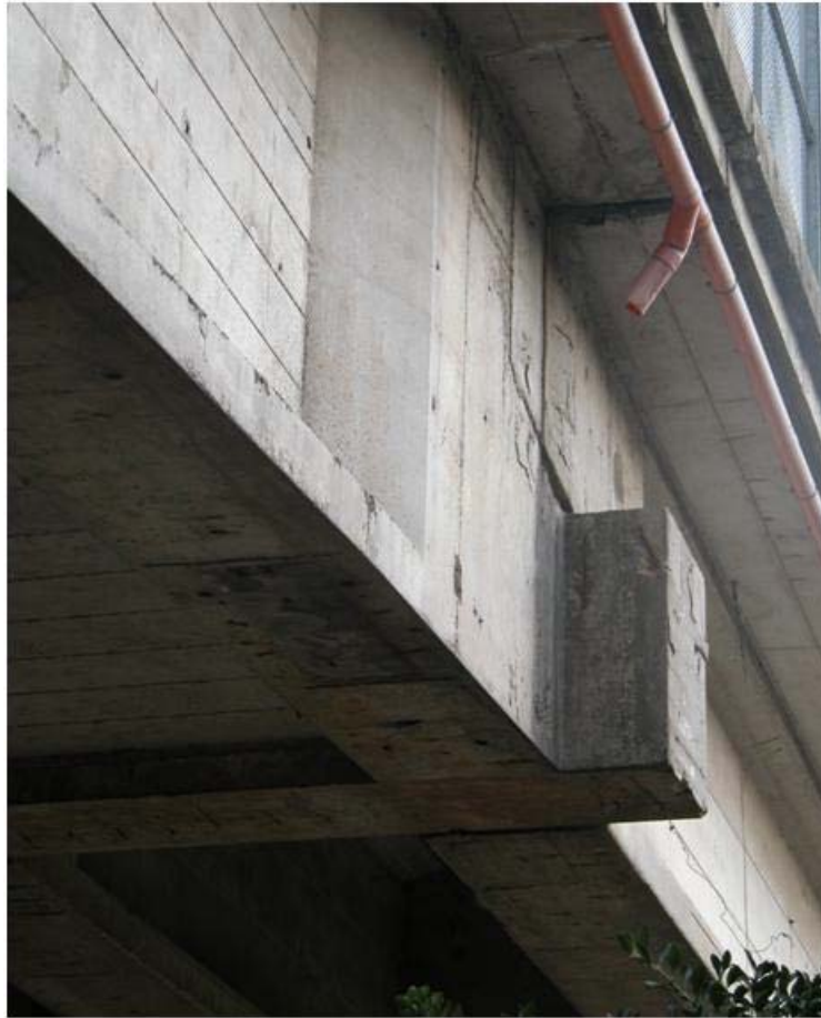
Figura 9. Pluviale di scarico delle acque di piattaforma che riversa le acque su di una sella Gerber presso il viadotto di accesso al ponte di Ficarolo.
