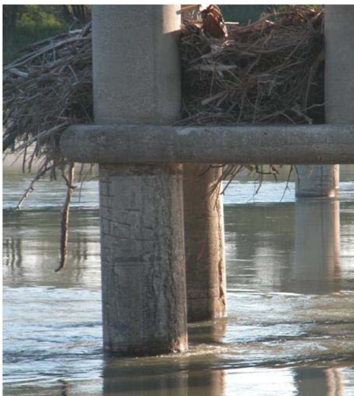
Figura 7. Corrosione delle pile in alveo al ponte di San Daniele.
