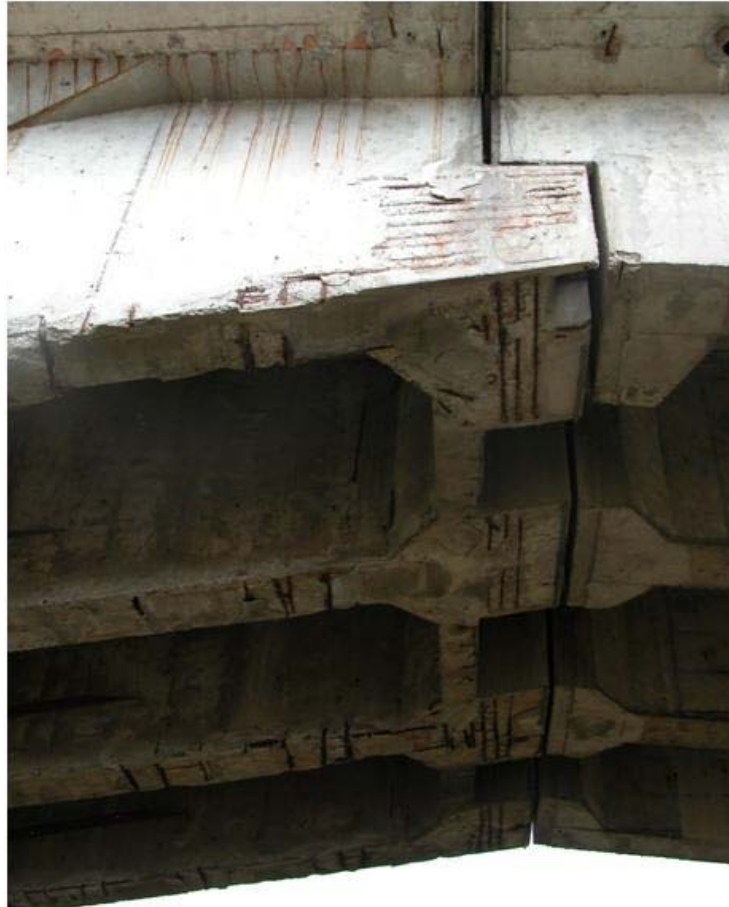
Figura 4. Degrado del calcestruzzo e corrosione delle armature in corrispondenza di una sella Gerber del ponte di Pieve Porto Morone.
