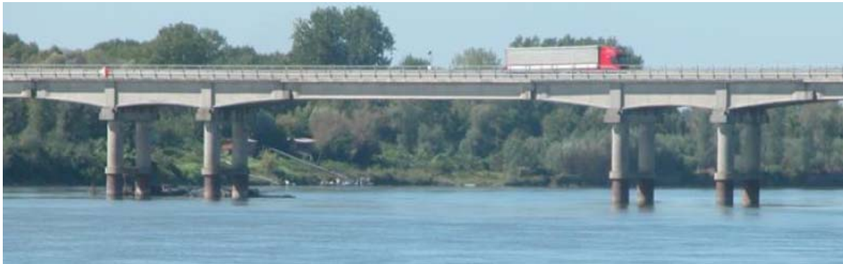
Figura 1. Fotografia che riprende una trave di campata, poggiante su due travi a mensola sorrette dai piloni (ponte di Spessa).
