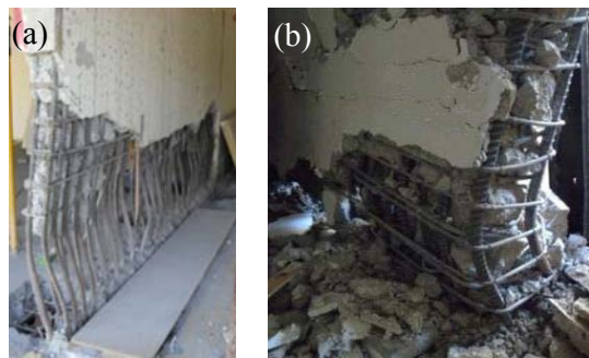
Figura 1. Esempi di pareti collassate per instabilità fuori piano dopo i terremoti: (a) in Cile del 2010 (NIST 2014); (b) in Nuova Zelanda del 2011 (Sritharan et al. 2014).
